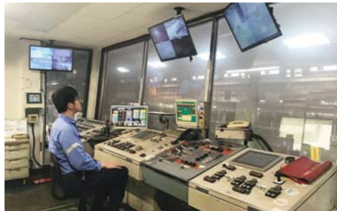
操作室 Operation room
